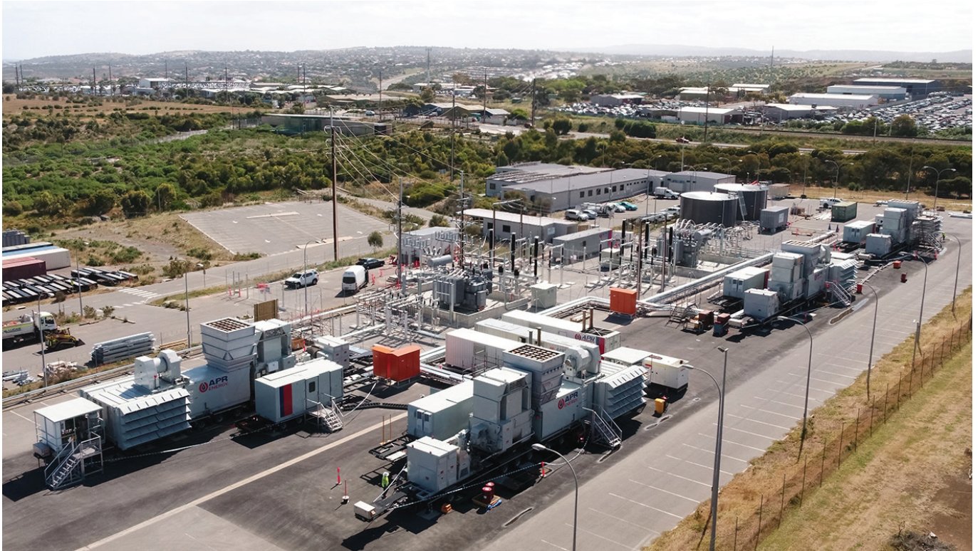
TG Sud centrale électrique, Adélaïde, A.S.
